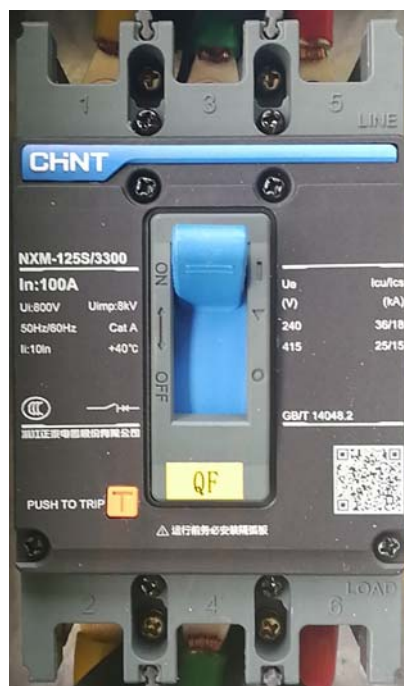
图3.1-1下电箱塑壳断路器（合闸状态）
